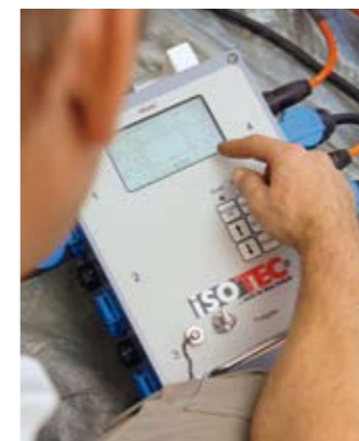
Das Temperaturregelgerät überwacht die Trocknung.
