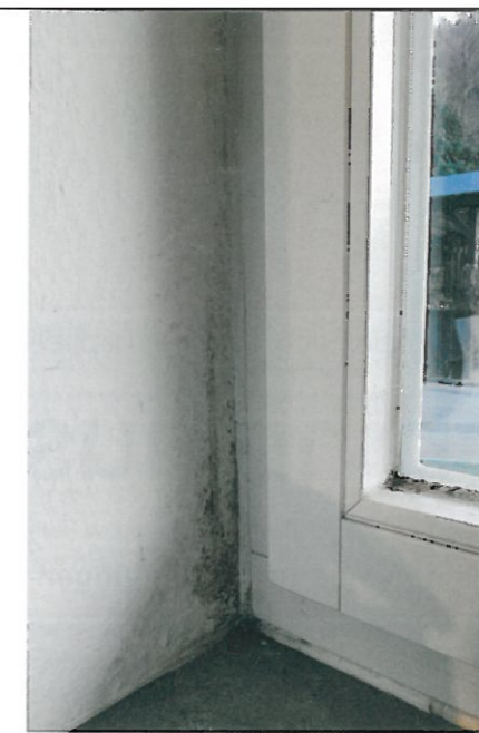
Schadensbild: Raumecke zur Außenwand.
